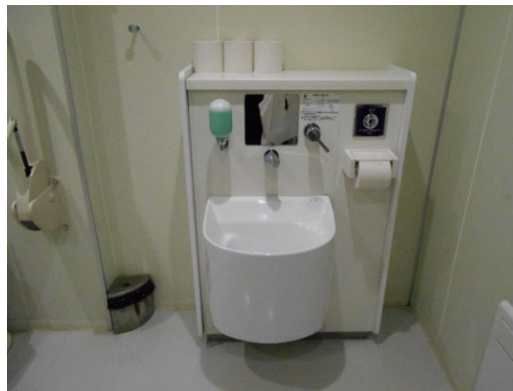
図表2-2-15 庁舎に設置されたオストメイト設備の例
